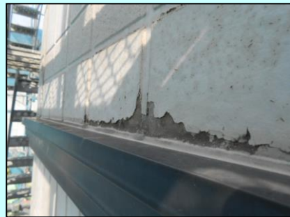
外壁が痛み、浮いたようになっています
