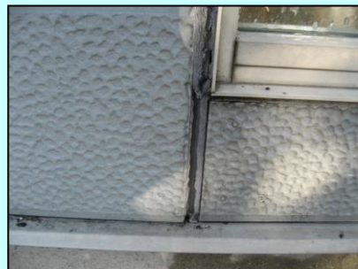
壁の目地シーリングにヒビが入っています
