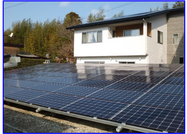
屋根と庭に太陽光発電を設置。
