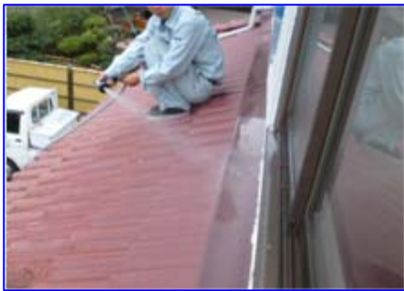
雨漏り箇所 調査中
