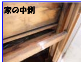
家の中側 雨が染みこんで 黒くなっています
