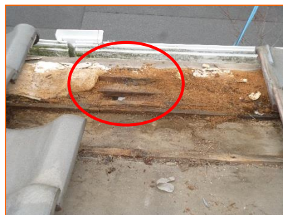
瓦を外したところ、下地に穴
